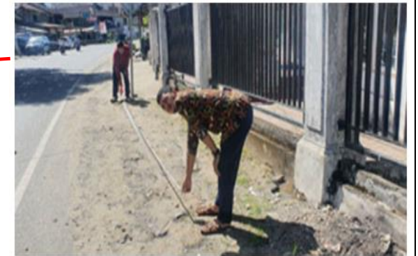
Lokasi Pemasangan Pipa Jalur JDU ND. 200 mm ( Jln. Nasional Tapak Tuan - Meulaboh Desa Geulumpang Payong )
